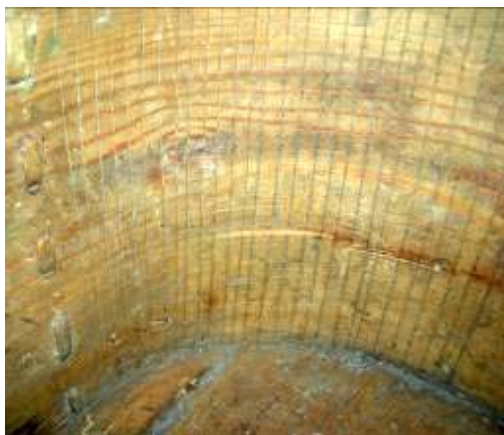
Bild 29 Rak ristning i hörnet på äldre spansnsvap
